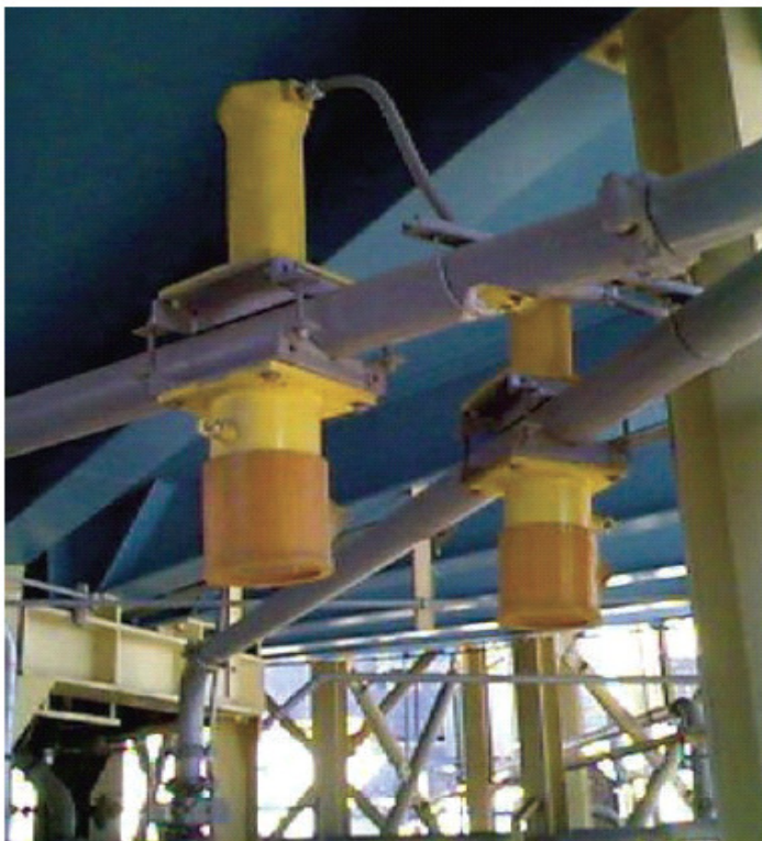
Фигура 6. Уред за измерване на плътност, монтиран на тръбопровод
