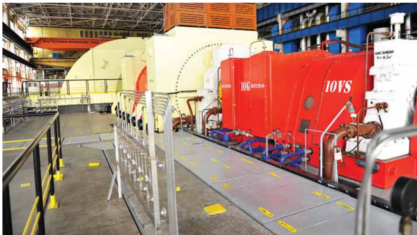
Машинна зала на блок 6, Снимка АЕЦ „Козлодуй“
